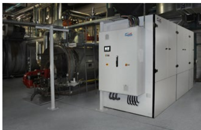
Abbildung: YADO|KWK Erdgas BHKW im Heizhaus
