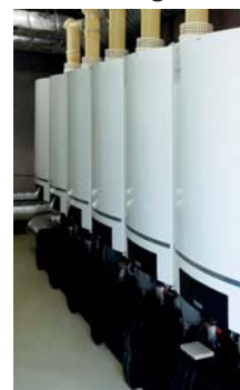
Foto: 6-Thermenheizkesselanlage 570 kW, Teil des HAST-AKKU® & LEGIO-PROPHY®-Systems, Hotel Bei Schumann
