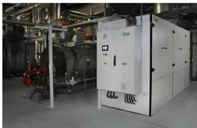
Abbildung: YADO|KWK Erdgas BHKW im Heizhaus
