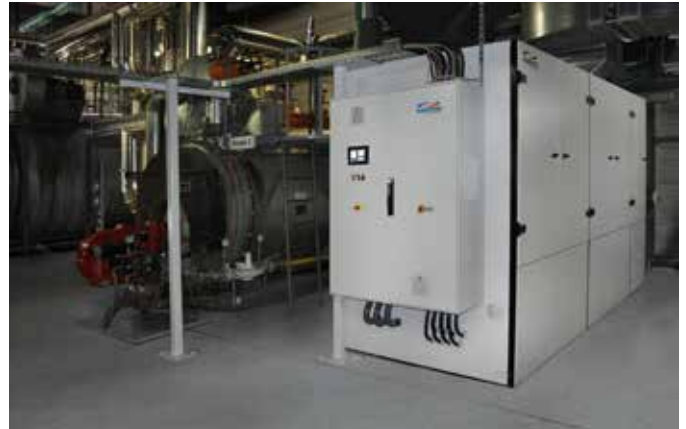
Abbildung: YADO|KWK Erdgas BHKW im Heizhaus
