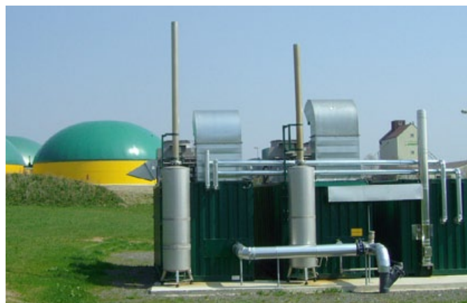
Abbildungen: YADO|KWK Biogas Anlage in Modulbauweise
