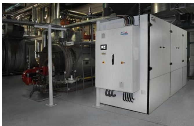
Abbildung: YADO|KWK Erdgas BHKW im Heizhaus
