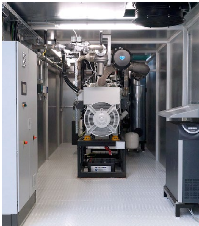
Abbildung YADO|KWK Blockheizkraftwerk im Systemcontainer
